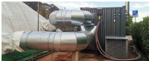
La chaudière à pellets
