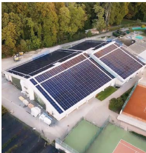
880 panneaux photovoltaïques sur le toit de la halle de tennis à Bois-Bougy. Un coup gagnant pour le climat !
